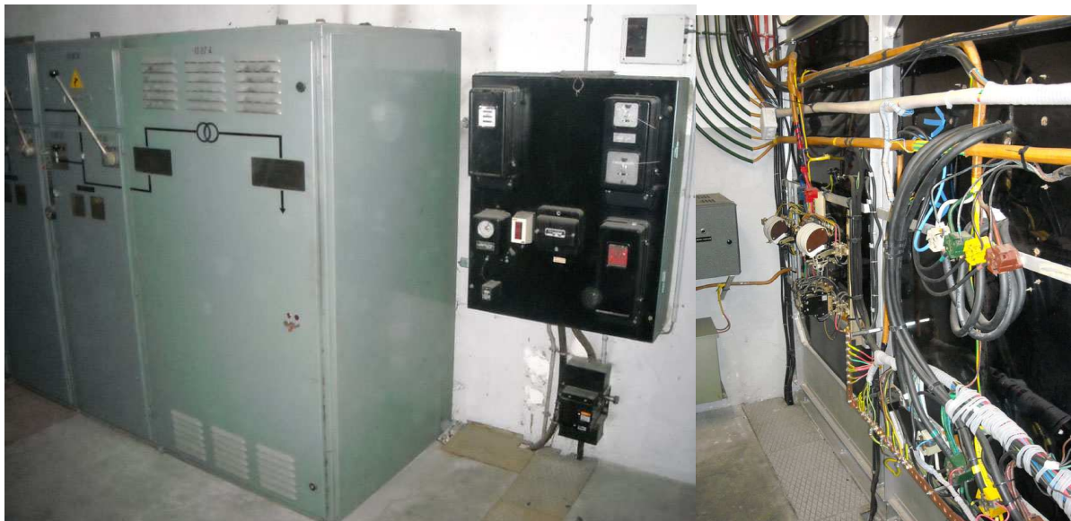
Fig. 2.6. Transformateur et sectionneur principal – Vue arrière du TGBT.
