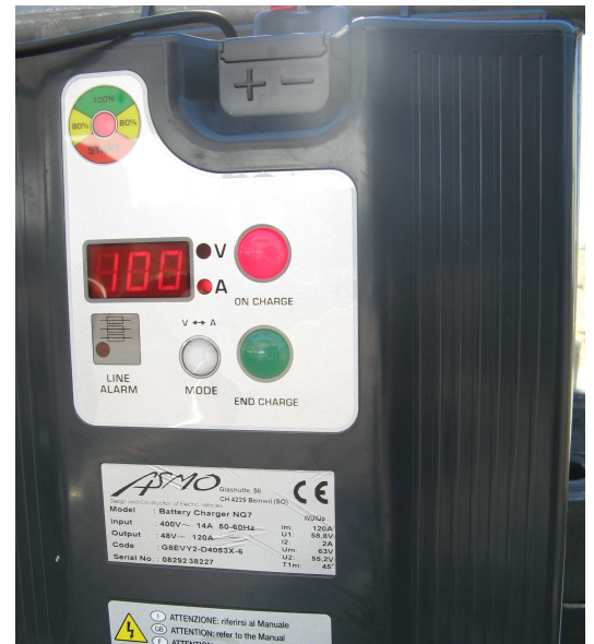
Un chargeur de batterie à 48V/100 A pour le ravitaillement
